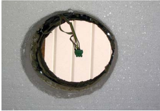
Bild 1: Rohbauöffnung mit Kabel
